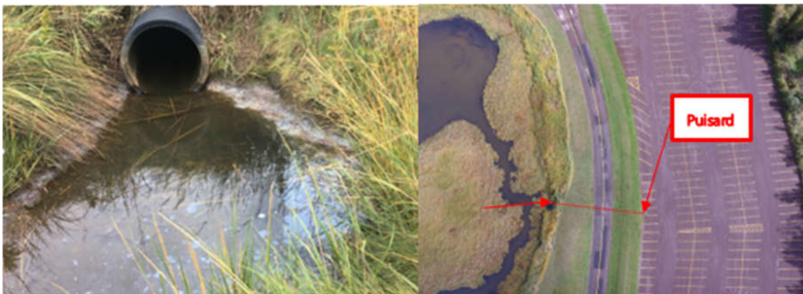
Figure 2-7 : Sortie d'eau pluviale n° 5 (tuyau en PEHD de 600 mm de diamètre)
