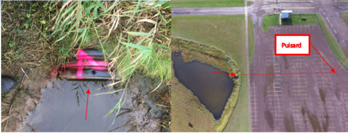
Figure 2-6 : Sortie d'eau pluviale n° 4 (tuyau en polyéthylène haute densité [PEHD] de 450 mm de diamètre)
